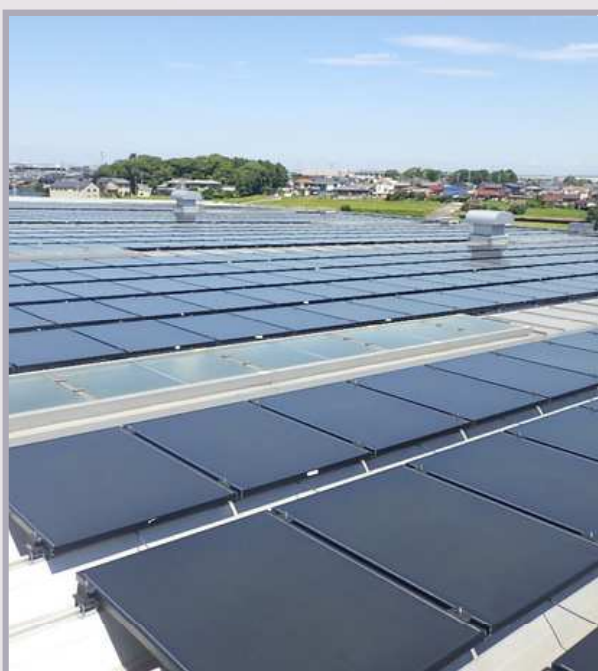
太陽光発電システム
